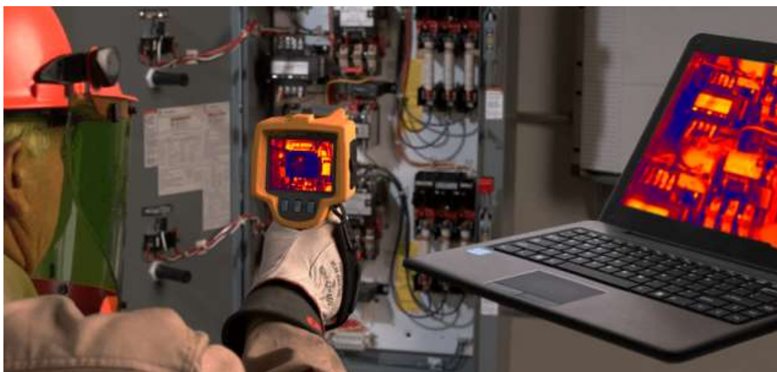
Рисунок 20. Пример проведения тепловизионного контроля электрошкафа
